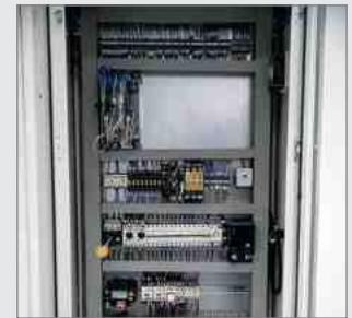
Sehr gut strukturierter Schaltschrank mit hochwertigen Komponenten von Schneider, Mitsubishi, Delem und Fiessler
